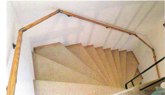
Mit gebrochenen Ecken – gefährliche Stufen innen
